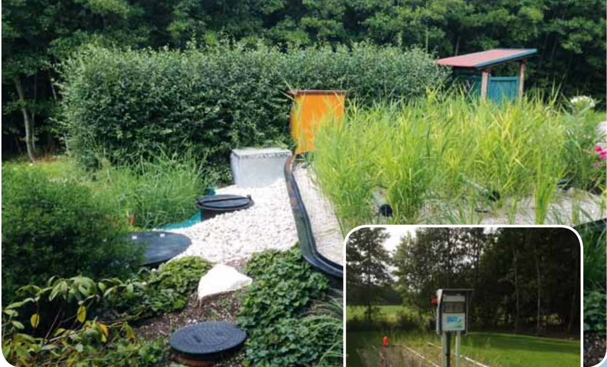
Pflanzenkläranlagen in Betrieb ...
